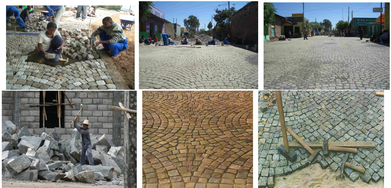
ስእሊ 1.20 ኣብ ከተማታት ሃገርና ካብ ገጠር ናብ ከተማ ዝሰሓቡ ሰባት ብገፊሑ ዝዋፈሩሉ ስራሕቲ መንደቕን ምንፃፍ ዕሩብ እምንን
